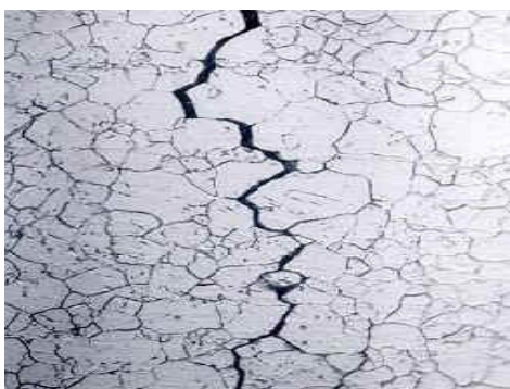
Рис. 3. Сорбційний – утворення колоній тріщин
