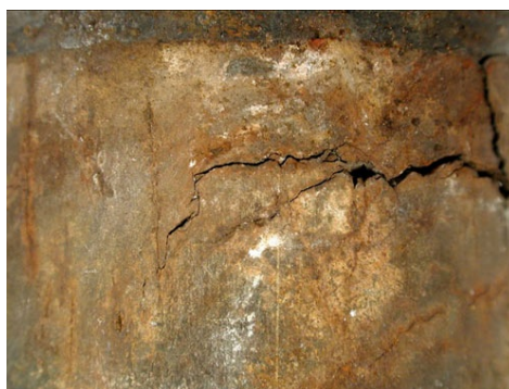
Рис. 4. Завершальний – руйнування трубопроводу
