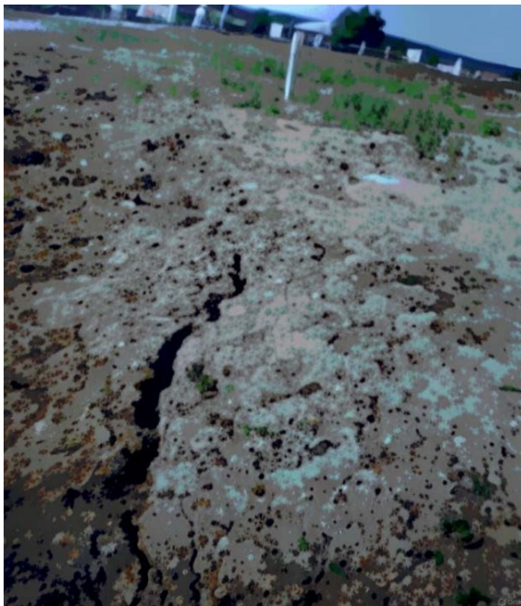
Рис. 2. Тріщини ґрунту над газопроводом
