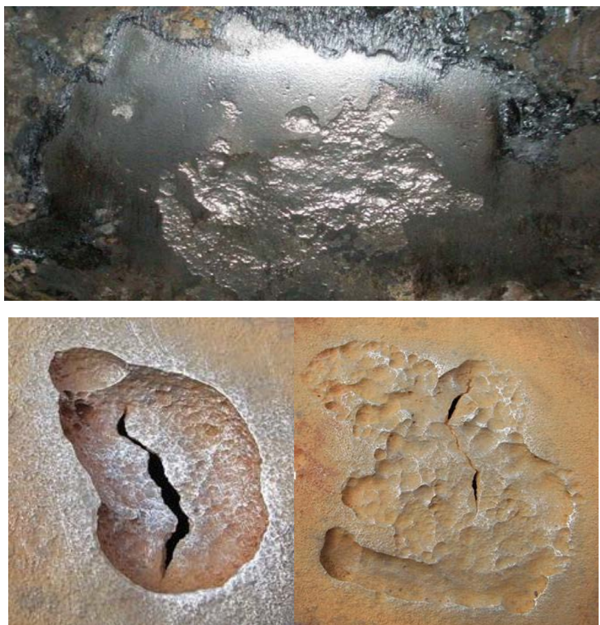
Рис. 3. Корозійні пошкодження та тріщиноподібні криволінійні дефекти лінійної частини нафтопроводу
