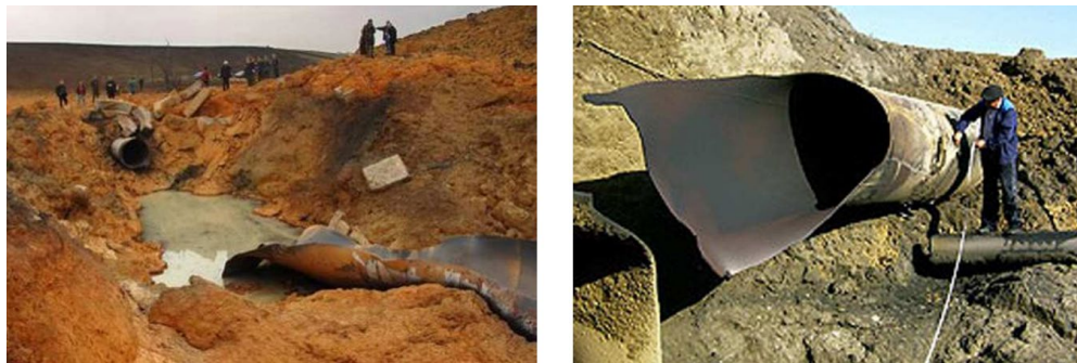
Рис. 2. Наслідки аварії на газопроводі, спричинені витоками газу
