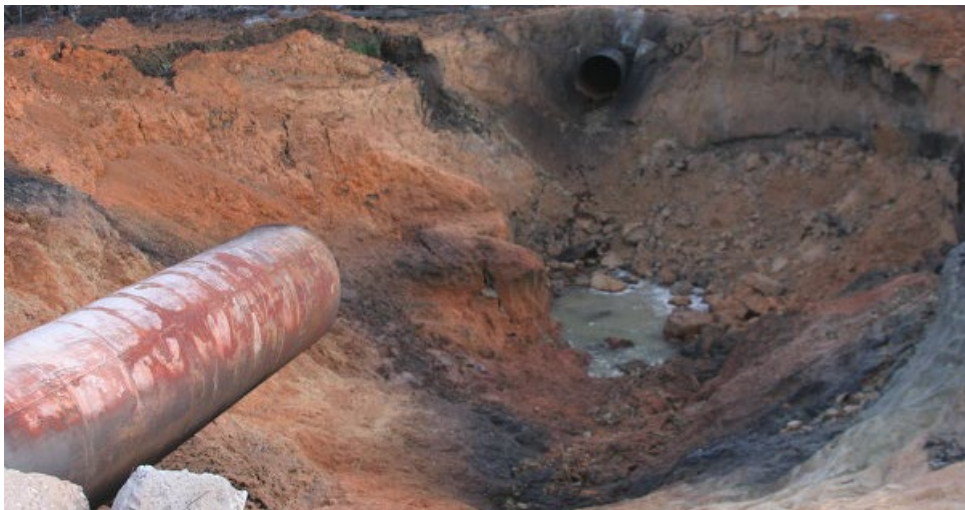
Рис. 4. Порушення герметичності магістрального газопроводу «Уренгой – Помари – Ужгород» внаслідок вибуху
